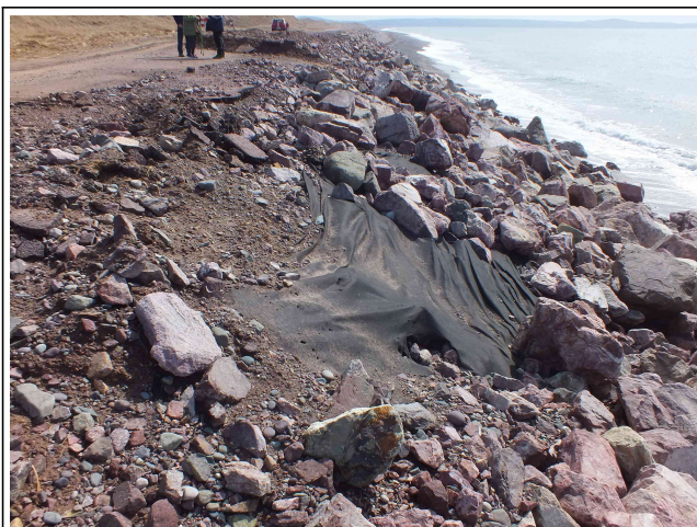
Glissement des enrochements Aval
