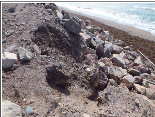
Effondrement extrémité amont près de la rampe
