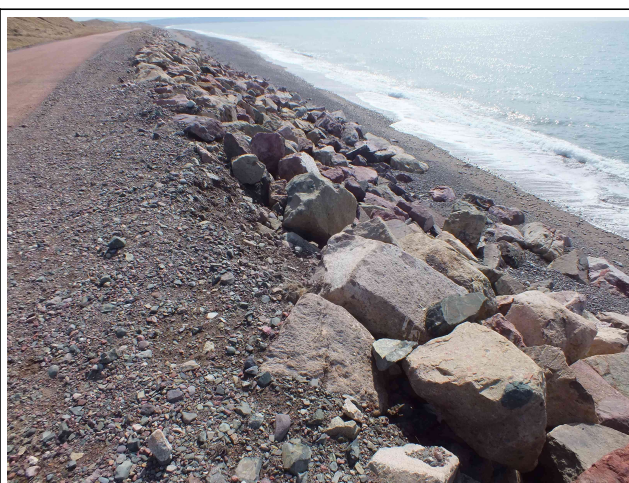
Glissement enrochement Aval
